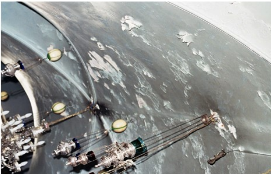
Ι.Ν. του Αγίου Κωνσταντίνου - Η κατάσταση των σταυροθολίων πριν και μετά την επέμβαση του 2013 Επάνω . Μετά την επέμβαση στο μνημείο με επιχρίσματα Mineral της Weber St. Gobain .
