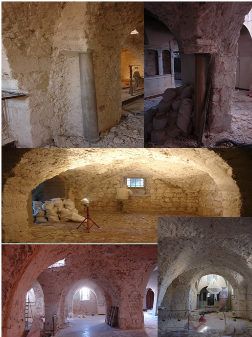
Ι.Ν. του Αγίου Κωνσταντίνου - Η κατάσταση των σταυροβολίων... μετά την αφαίρεση των επιχρισμάτων.
